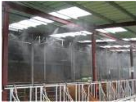
<축사 내부 스프링쿨러>
